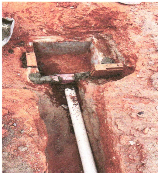
FOTO 145: CAIXA DE PASSAGEM ESGOTO
