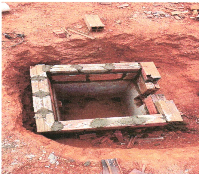
FOTO 146: CAIXA DE PASSAGEM ESGOTO
