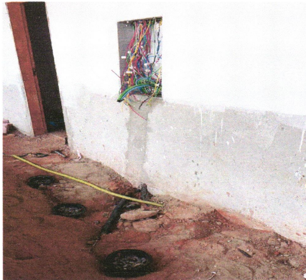
FOTO 152: INSTALAÇÃO ELÉTRICA – QUADRO E ATERRAMENTO
